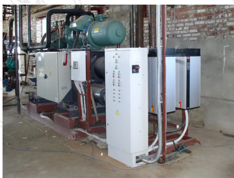
Щит для управления тепловым насосом
