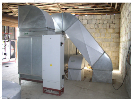
Щит силового ввода климатической установки
