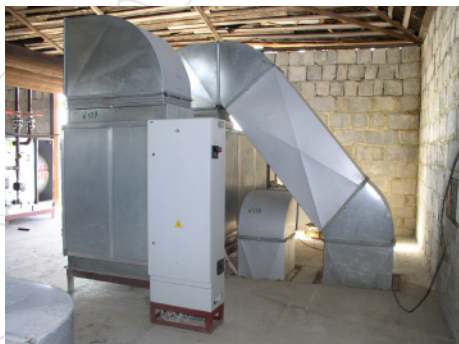
Щит силового введення кліматичної установки
