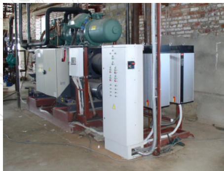
Щит для керування тепловим насосом
