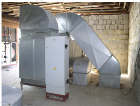
Щит силового введення кліматичної установки
